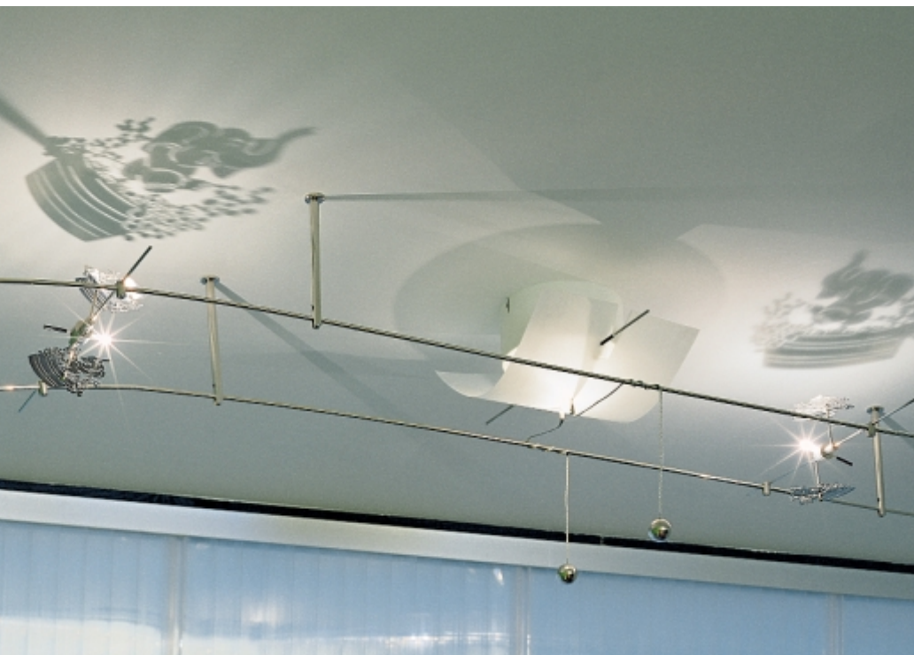
Zwei B. Franklin und ein beleuchteter Deckentrafo setzen Akzente
