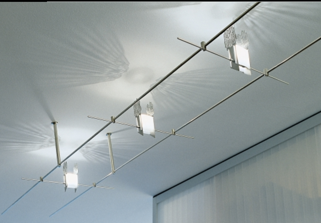
Basic-Stangensystem mit drei Mainhatten als Flurbeleuchtung
